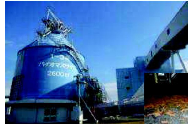
バイオマス燃料設備
